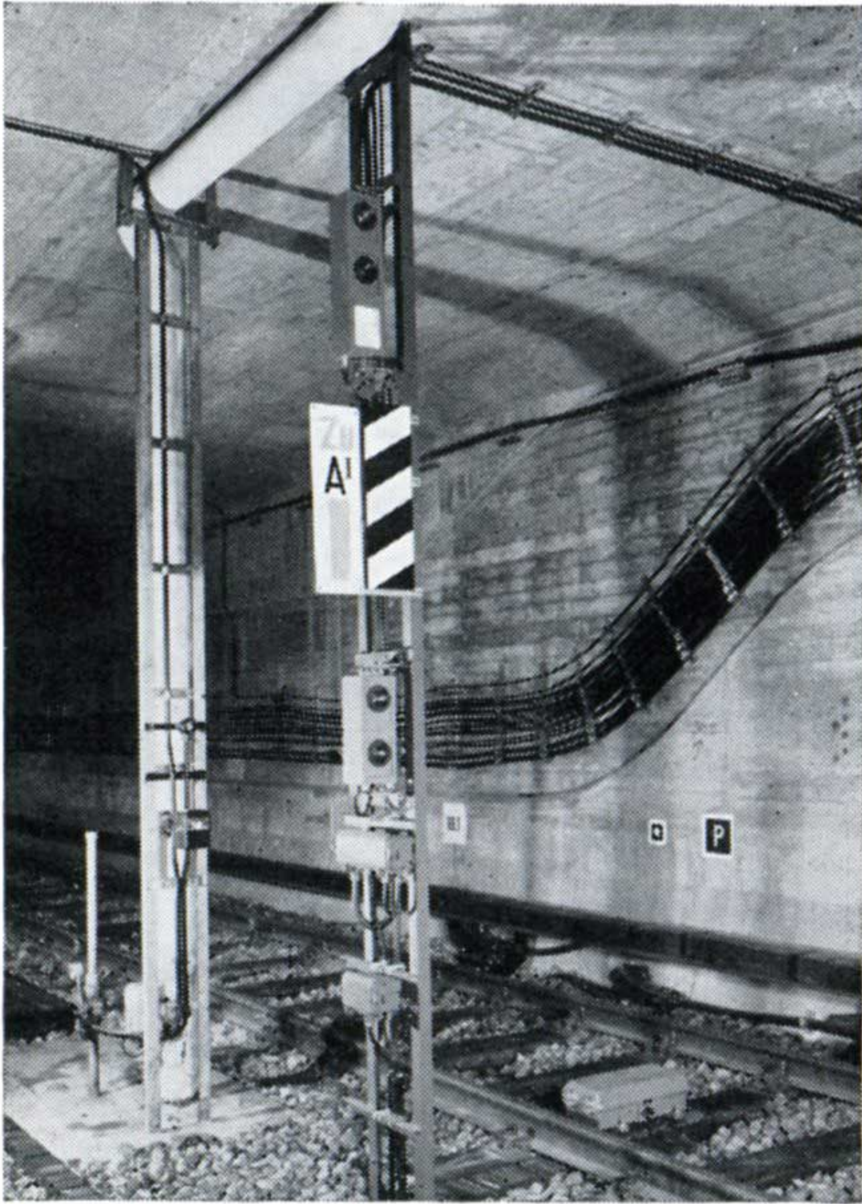
Signal d'entrée de la gare «Jardin Zoologique». On remarque entre les rails le contact magnétique d'arrêt automatique des trains.
