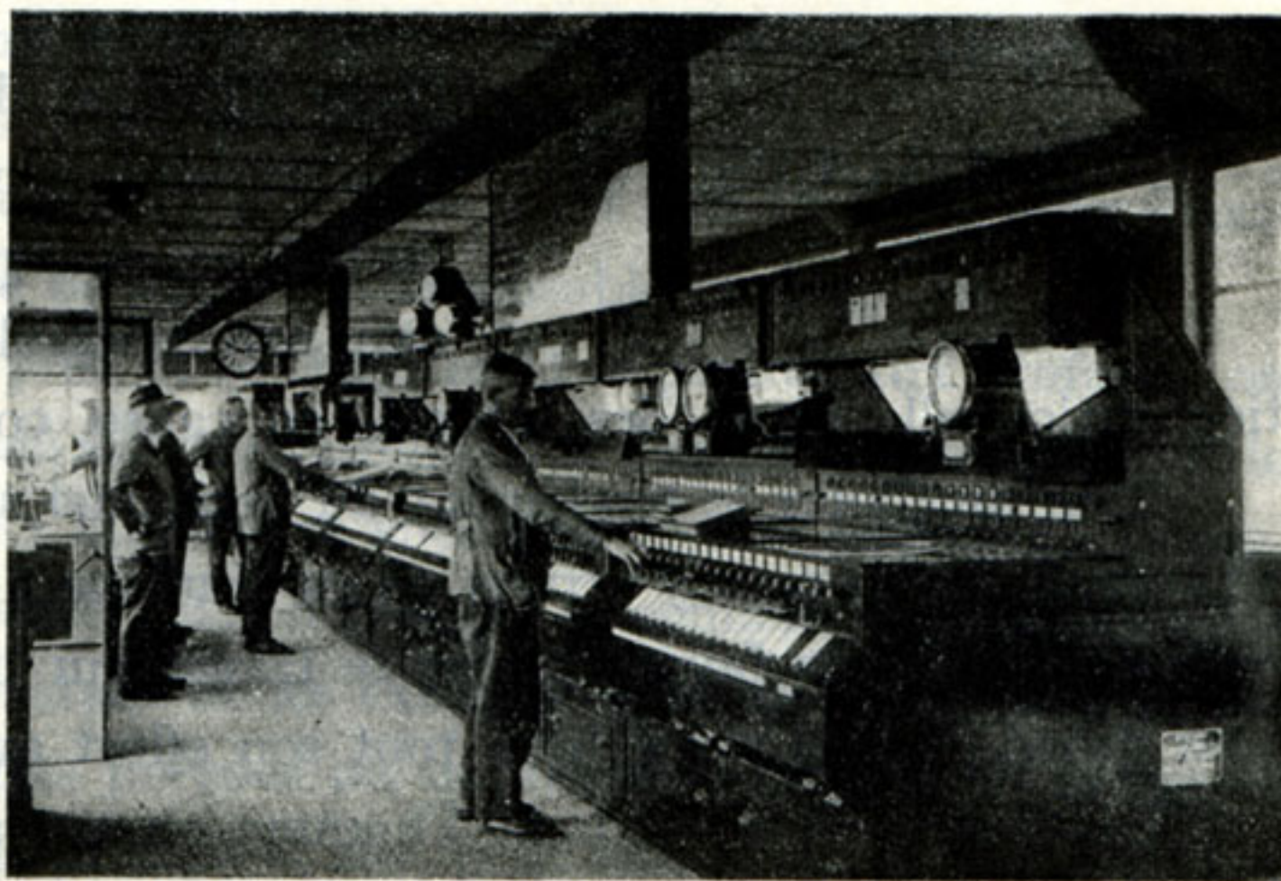
FIG. 11. — Intérieur cabine électrique : signaleurs au travail.
